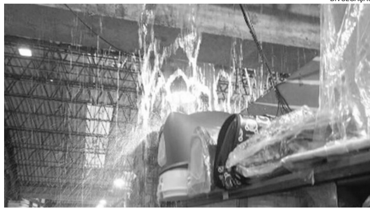
■ Volume de água comprometeu o sistema de captação do telhado, resultando em uma espécie de "cachoeira" no interior do espaço
